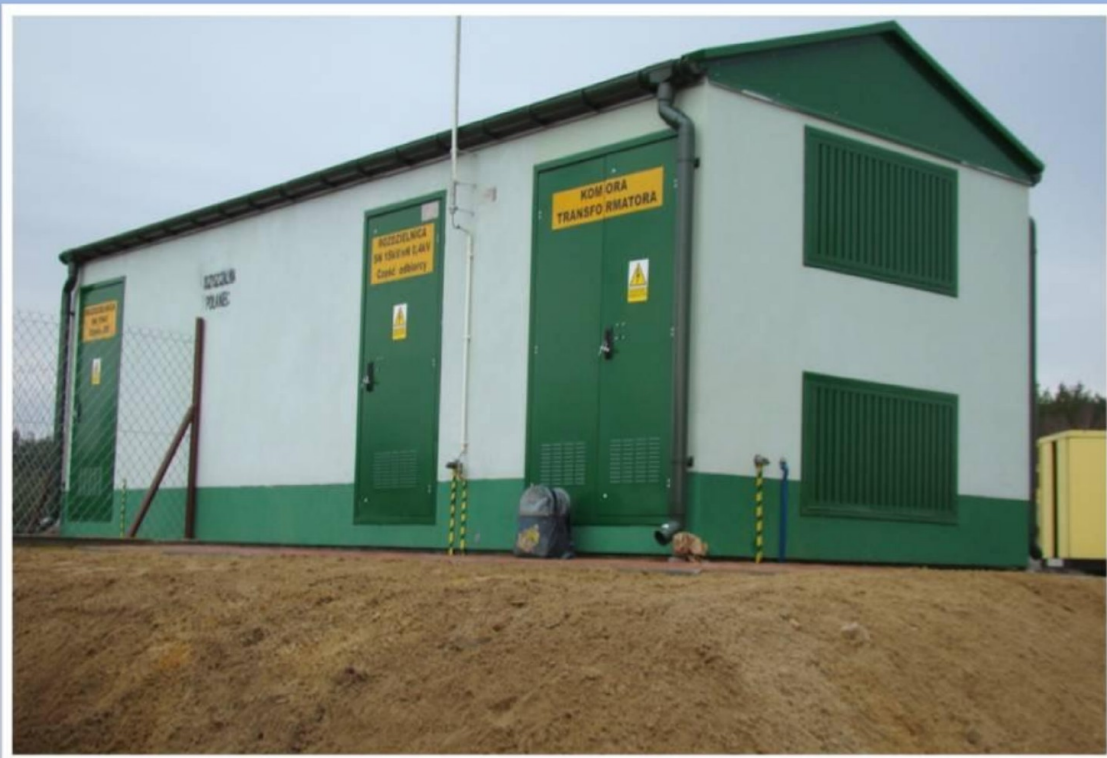
Nowa stacja trafo
