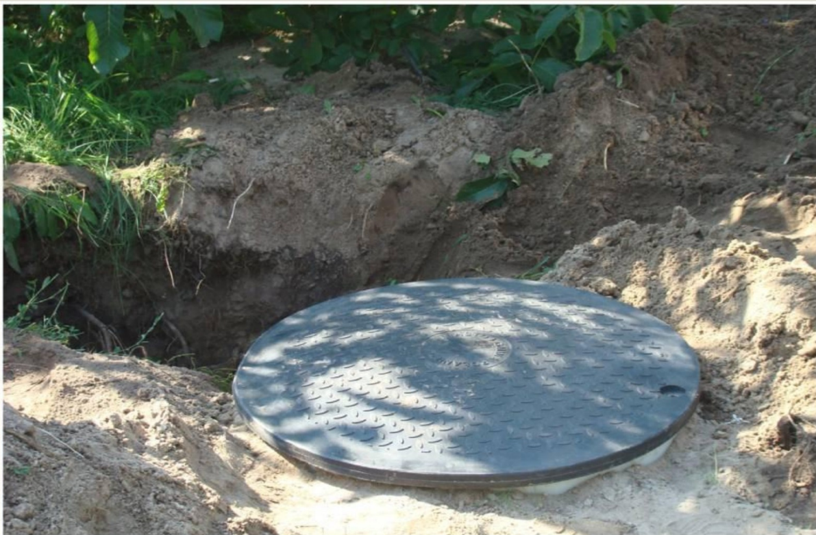
Zabudowana pompownia przydomowa
